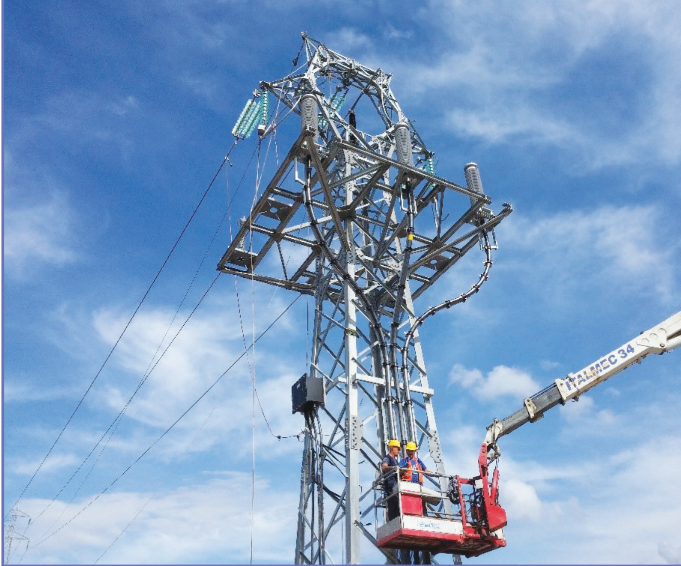
Rete di trasmissione elettrica di Alta e Altissima Tensione - Campania
